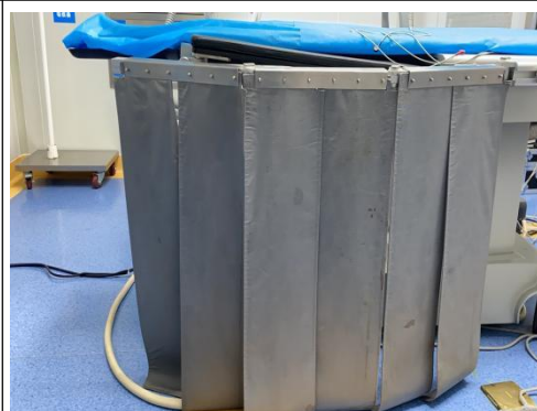
床下铅帘 (DSA2 机房)
