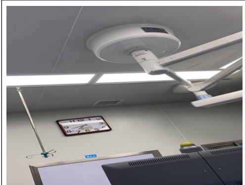
通风系统 (DSA2 机房)
