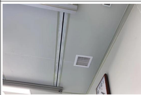
通风系统 (DSA1 机房)
