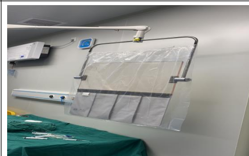
床上吊帘 (DSA1 机房)
